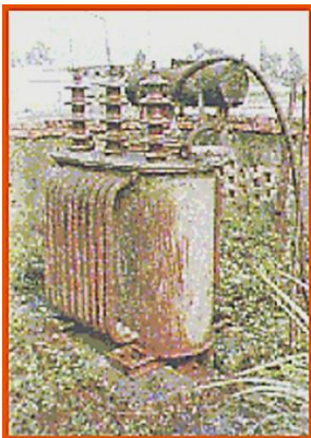
TRANSFORMADOR ELÉTRICO com PCB's
