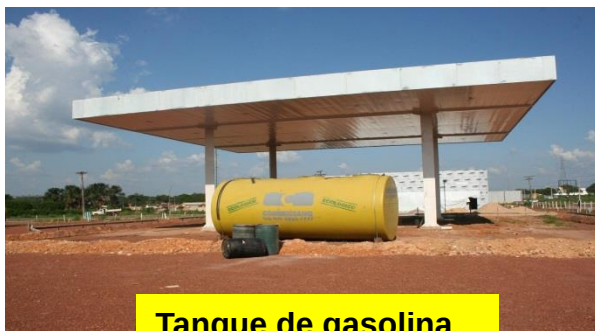
Tanque de gasolina
